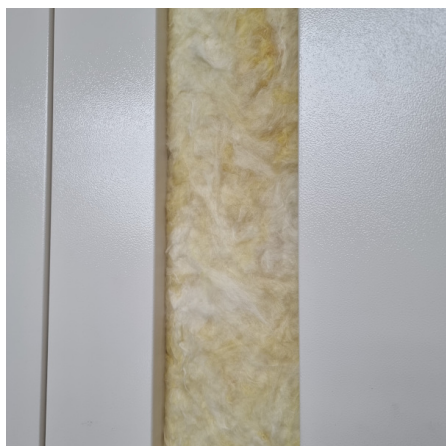
Obudowa izolowana, z paneli łatwo demontowalnych
